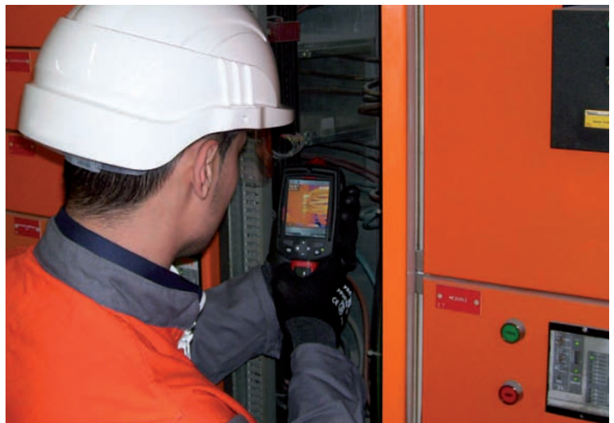
Contrôle d'un tableau par caméra infra rouge
